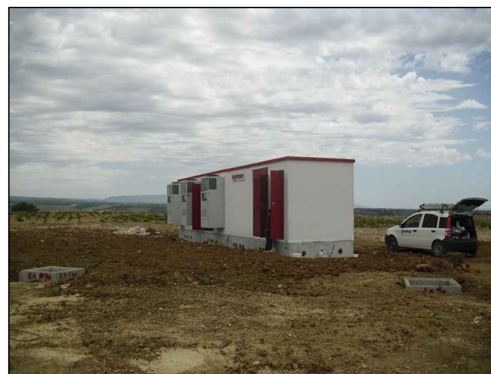
Poste de Transformation
