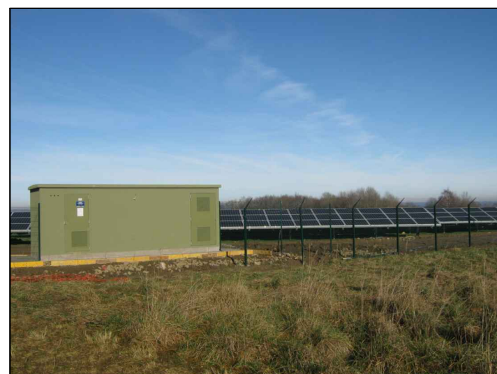
Poste de Livraison
