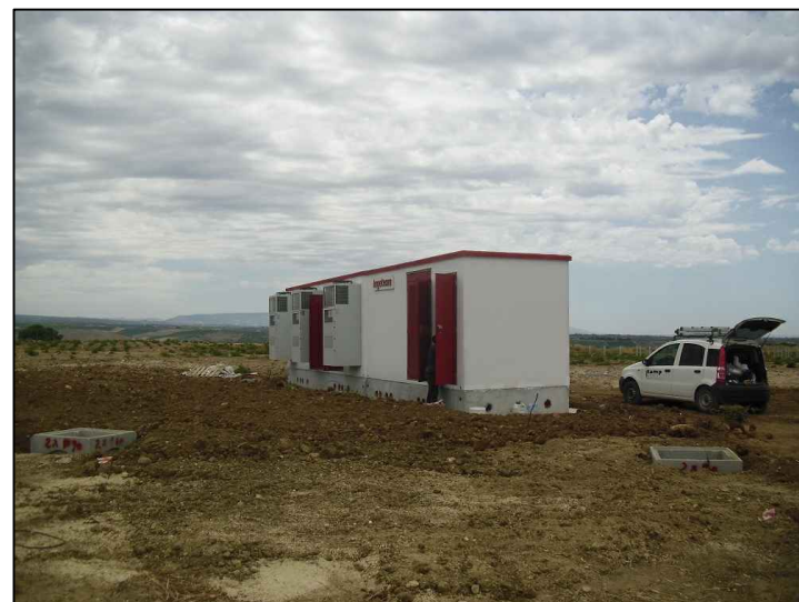
Poste de Transformation
