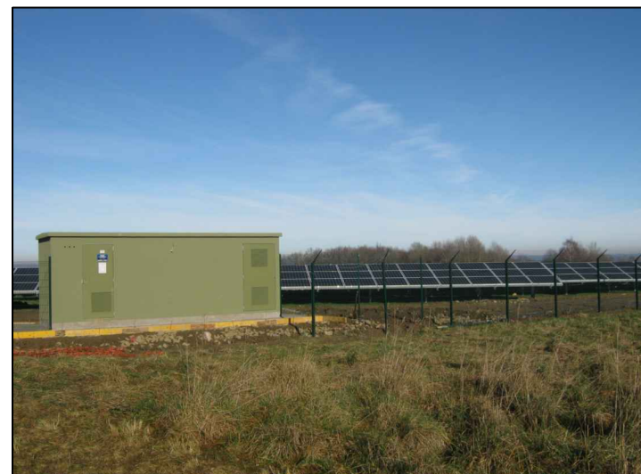
Poste de Livraison
